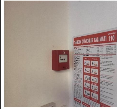
Yangın Alarm Butonu
